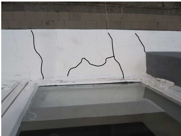
7. 6B. Gesims over 3. sal, Hér ved opgangsvindue, fremstår med en del svindrevner i den pudsede overflade. Vindue trænger til maleristandsættelse (revner delvist fremhævet med tusch på foto)
