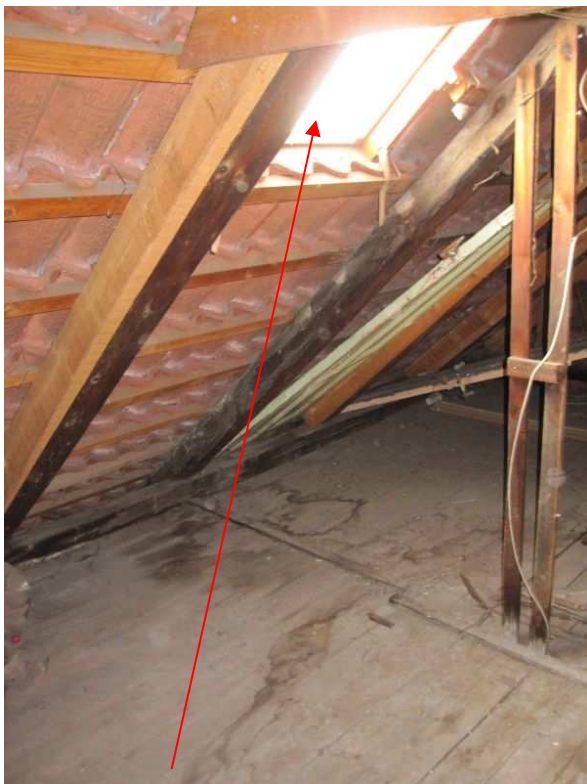
1. Skråvinduer i spidsloft, udført i plast, fremstår med delvist ødelagte beslag, men forekommer dog i tæt tilstand.
