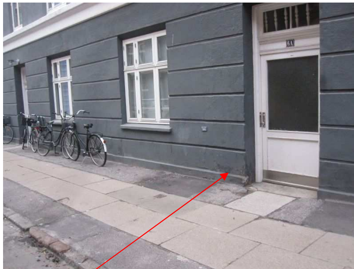
8. 6A: Afskallet puds til venstre for indgangsparti
