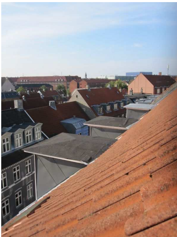
3. Flere tagpapbeklædte kvisttage med dampbuler. Bulestørrelse forøges i varmt vejr og formindskes i koldt vejr, hvilket på sigt fører til revnedannelse og utætheder i tagpapbeklædning.
