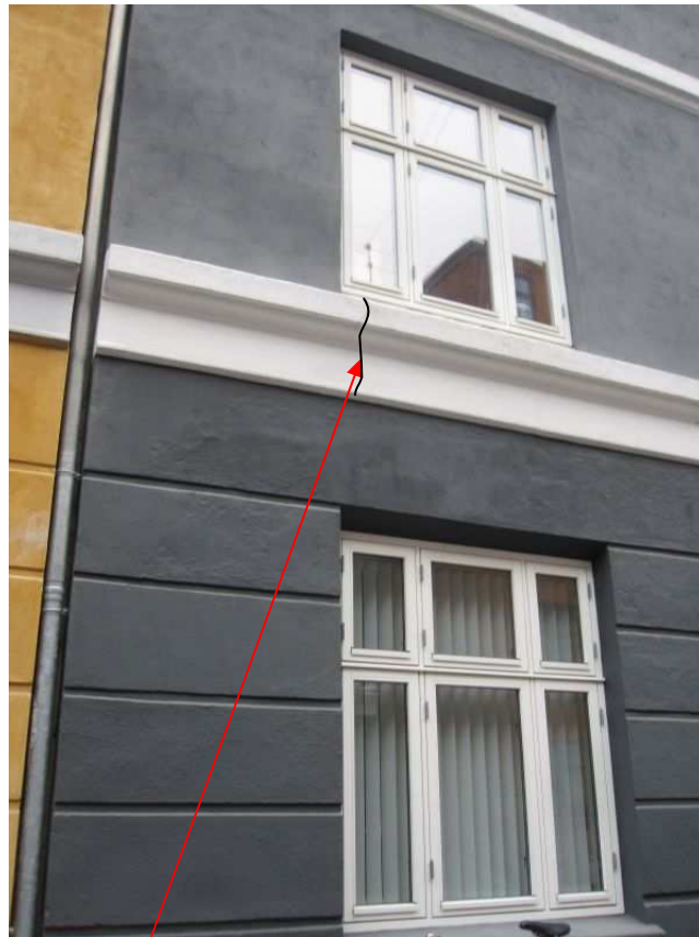
6. 6B tv. Lodret revne i gesims nær murfals.
